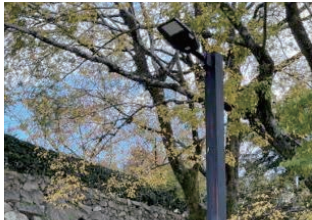
外灯スマートLED化整備
